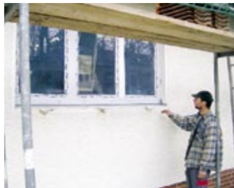
Auch während der Modernisierungsarbeiten müssen ständige Kontrollen sein, um die Qualität zu sichern.
