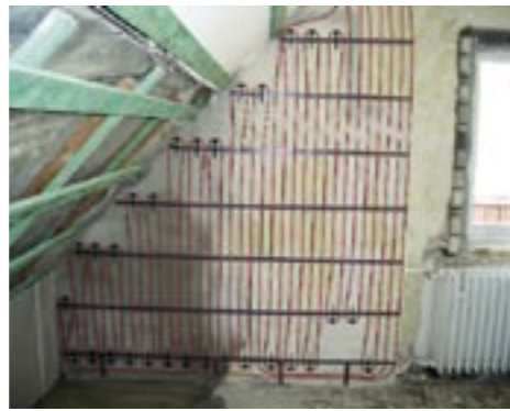
Mit dem überlegten Einsatz von Wand- und Deckenheizsystemen war es möglich, die Vorlauftemperaturen der Heizung auf maximal 35 Grad Celsius zu begrenzen.
